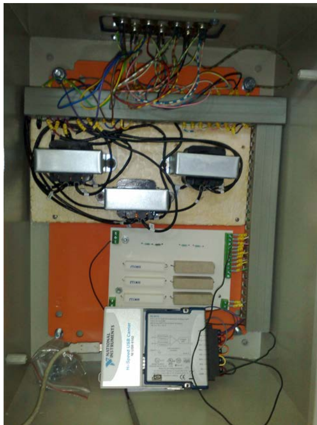
Figura 5.15: Imagen que muestra los elementos principales al interior del gabinete.
