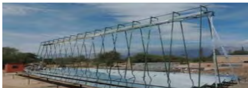
Figura 2.6. Planta solar Fresnel de foco lineal ubicada en Salta, Argentina.
