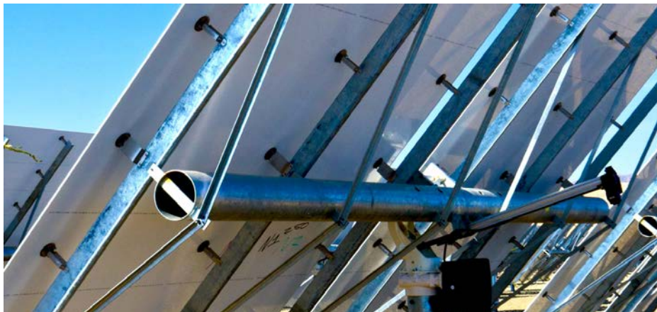
Figura 8. Conexión de los espejos a la estructura de soporte de acero mediante ventosas y pines.
