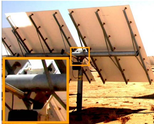
Figura 13. Detalle de la ubicación del eje de elevación de un heliostato. (Pfahl 2013)
