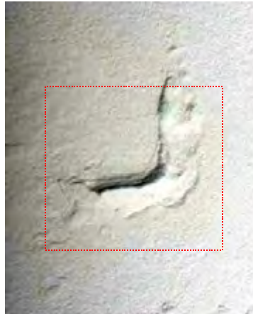
Figura 3.9 Daño en la parte superior de la barra 2.
