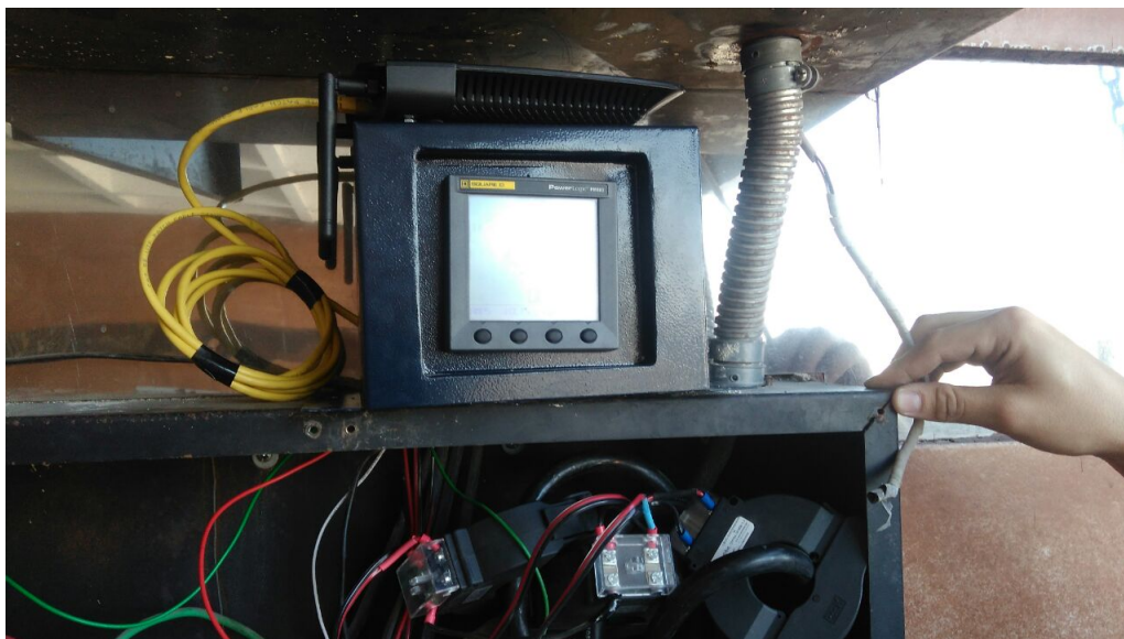
Figura 6-2.: Distribución de la instalación del hardware en Industrias Scalini [6].
