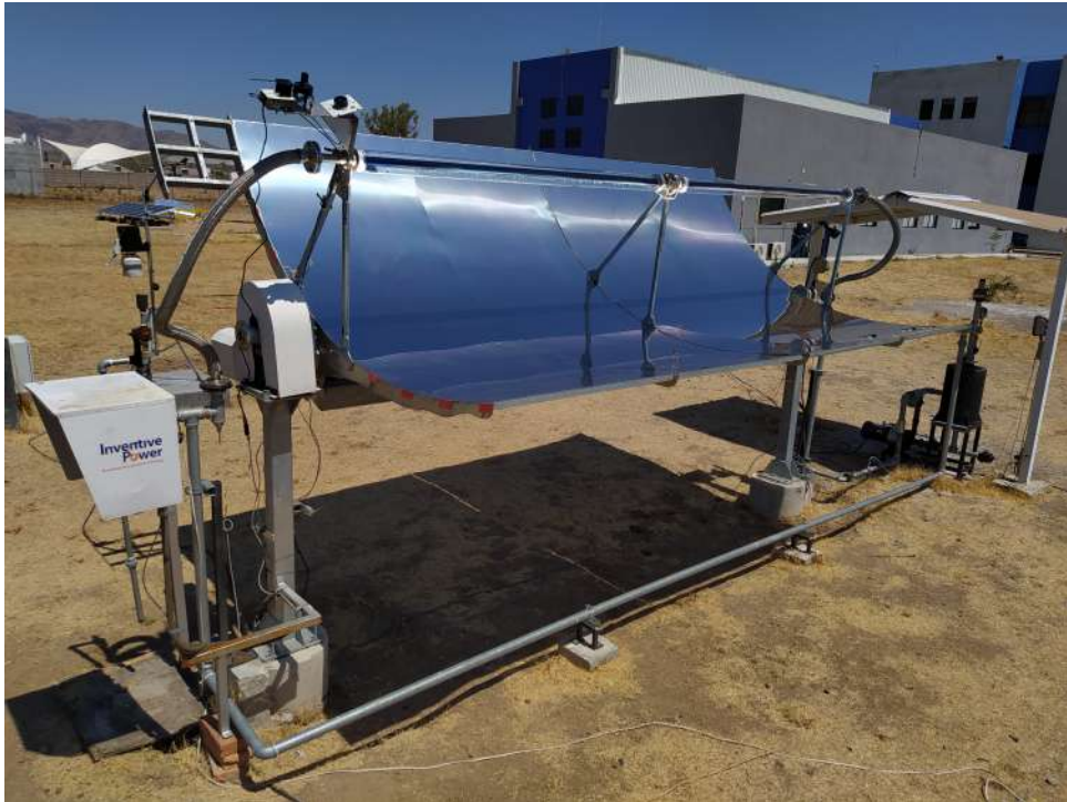
Figura 1.3: PTC Power Trough 250 ® instalado en el CIO-Aguascalientes.
